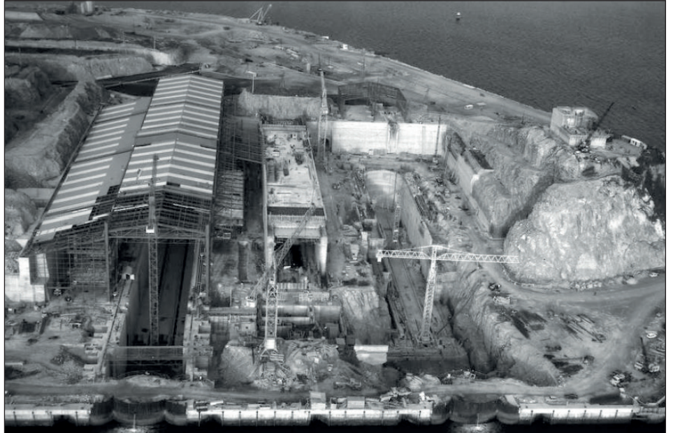
Le chantier titanesque de construction des bassins de l'île Longue entre 1967 et 1969. (Photo DR)
